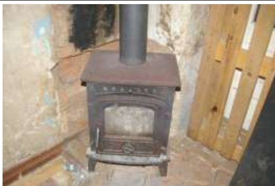
Būve ar kadastra apzīmējumu 6405 010 0182 001, dzīvoklis Nr.1, telpa Nr.3, krāsns
